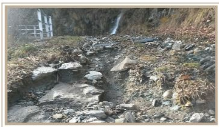
FOTO 3: Dissesto Strada Comunale Borgata Fontane – Borgata Serrevecchio (Dissesto 3)
