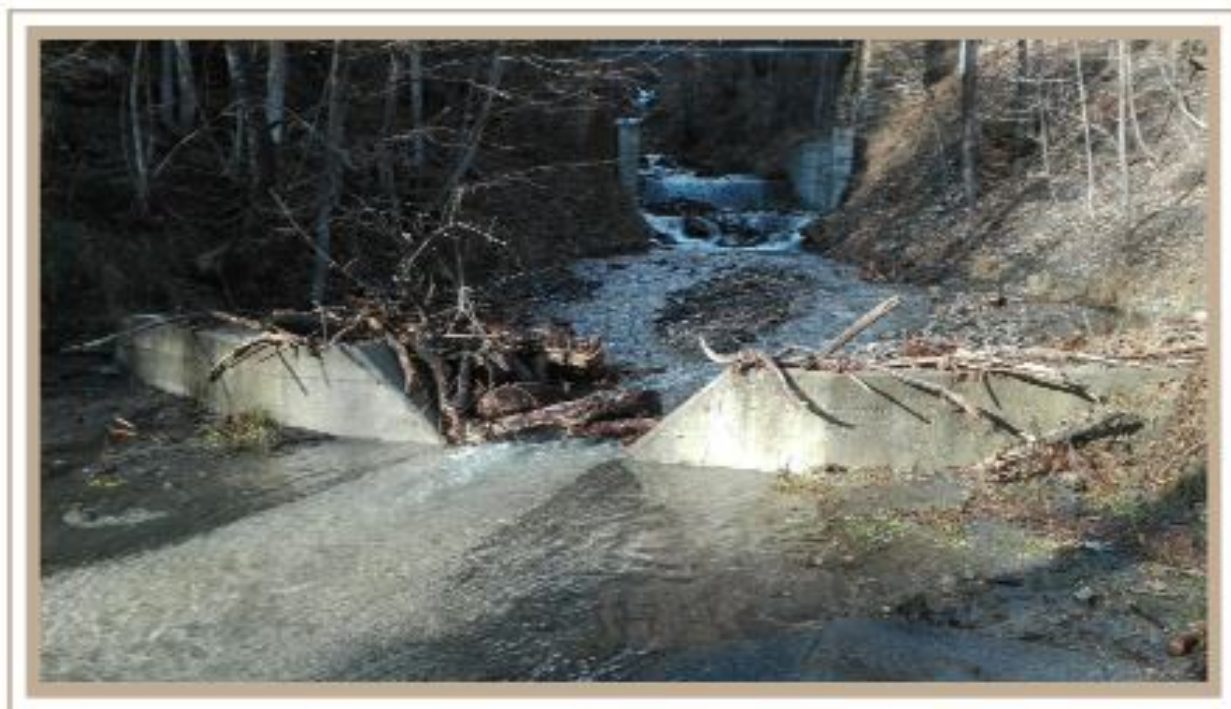
FOTO 4: Dissesto attraversamento del rio sulla Strada Comunale tra Borgata Campoforano e Borgata Serre (Dissesto 4)
